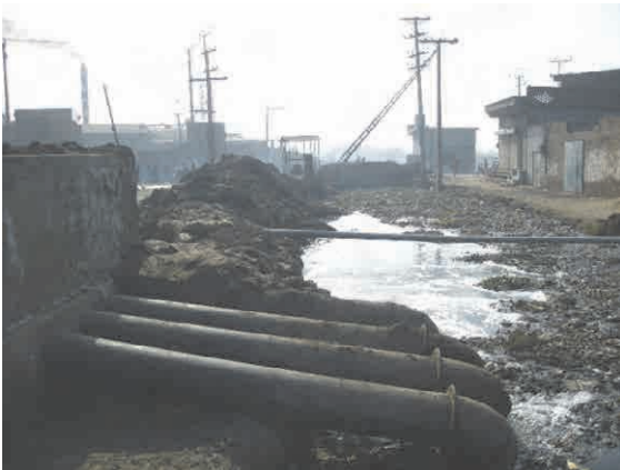
ポンプ場の排水路（土砂・ごみが堆積し、 清掃・しゅんせつを課題としている）
