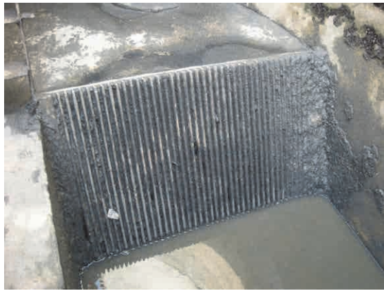
ポンプ場スクリーン設備 （手掻き式設備）
