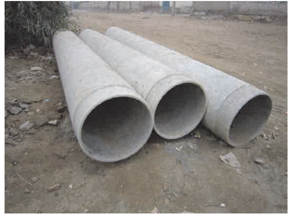
新規の配水管工事に使用されているアスベスト管（環境問題で先進国では既に使用禁止）
