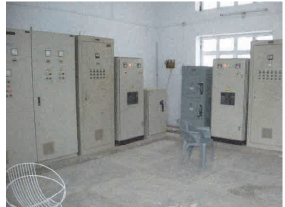
新設ポンプ場の電気室 明るく、整然とした維持管理がなされている。
