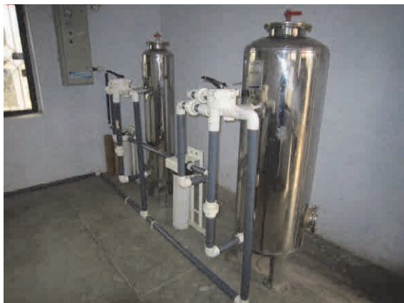
同左の公共水栓に設置してある砂ろ過+活性炭ろ過措置
