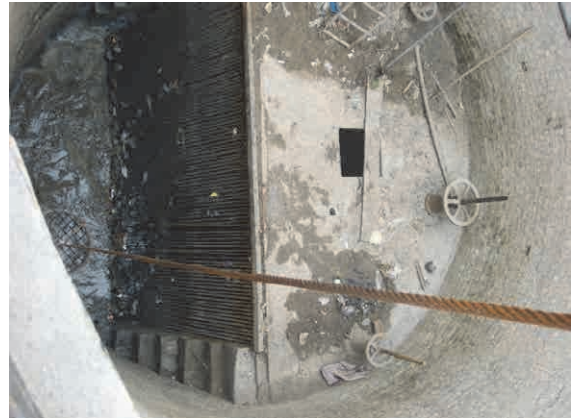
円形スクリーン室の内部 手掻きスクリーン、かごでゴミを除去する。
