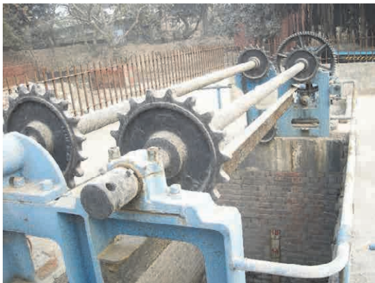
Main Outfall ポンプ場の流入渠 チェーンが老朽化し、欠落している。
