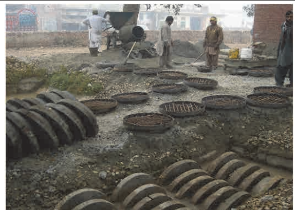
鉄筋コンクリート製マンホール蓋の製作状況 （手前は、水中養生中の蓋）
