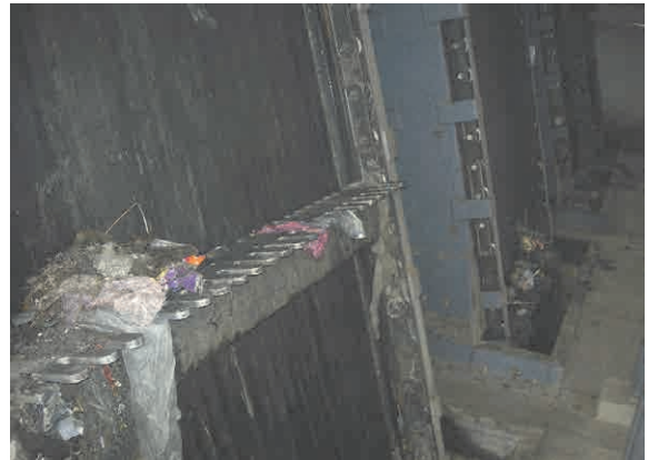
Main Outfall ポンプ場の除塵機 (良好な維持管理、家庭ごみが多い)
