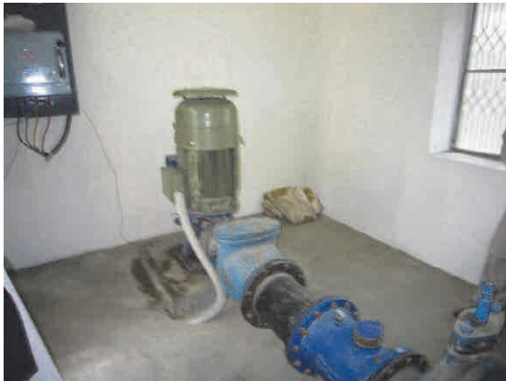
井戸ポンプ施設 (ポンプは縦軸ポンプ)
