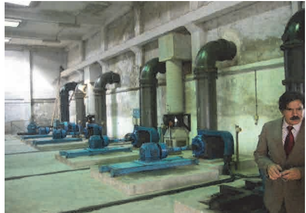
下水処理場内ポンプ場のモーター室・吐出管（良好な保守・点検がなされている）
