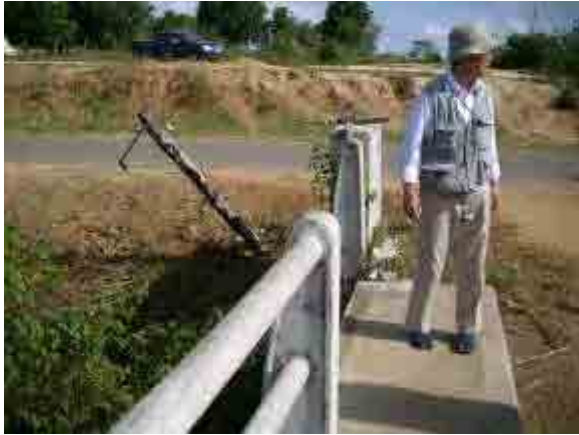
幹線水路に架かる橋の崩壊部と、傾いた動物 防除電気柵 (Branch Canal-2, Mayurapura Block)
