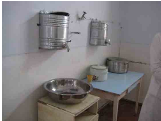
ジョミ郡中央病院手洗い場
