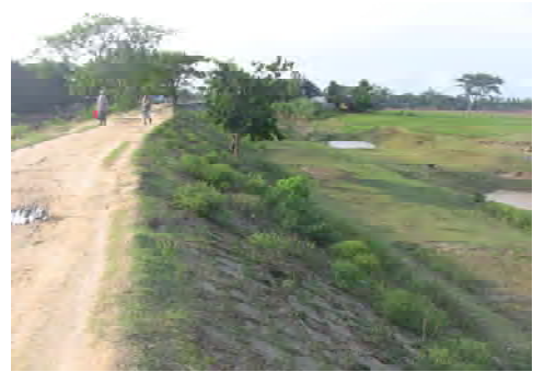
1b. Full Flood 堤防および護岸
