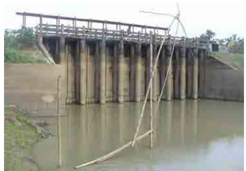
1d. Charervita 10 門樋門の鋼製ゲート
