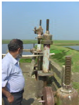
5c. 5号排水樋門の巻き上げ機
