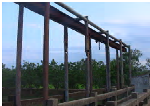
1e. harervita 樋門 Stop Log 引き上げ機
