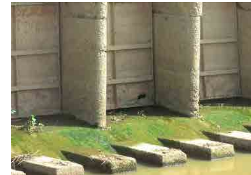
6d. Teli Khal 排水樋門フラップゲート
