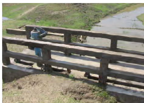
3c. Ganakkhali 2 門樋門操作台
