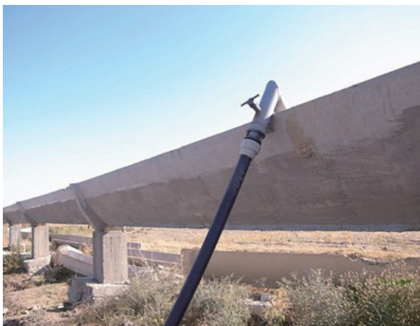
5. フリュームに設置したサイホン取水管
