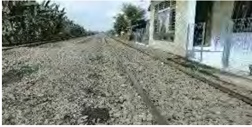
PC まくらぎの道床へのめり込み状況 (シンパン駅構内・クレタパティ駅方面)
