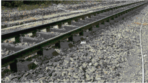
道床 (バラスト) の不足状況 (カランゲンダー駅起点方踏切付近 350+)
