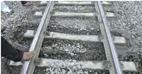
レール溶接部の噴泥状況 (プラブムリーX6 終点方踏切付近 330+)
