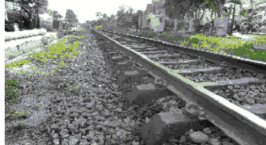
道床 (バラスト) の不足状況 (プラブムリー駅終点方踏切付近 320+)
