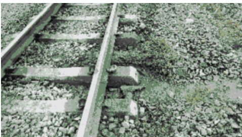
雨水による道床流失と締結装置の脱落 (グヌンメガン駅付近 368+)
