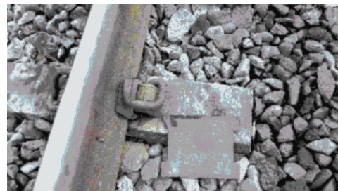
軌道パッドの老朽化 (グヌンメガン駅付近 368+)
