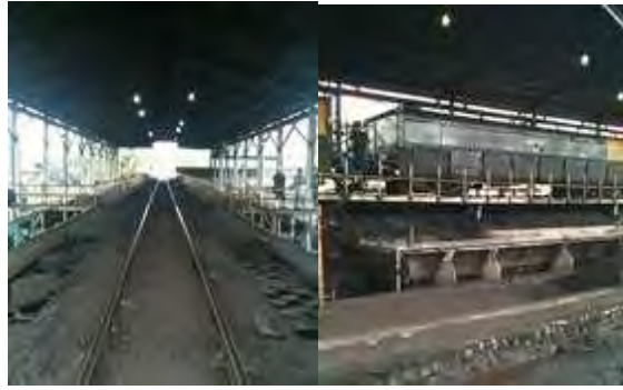
貨車からの石炭積降ろし設備
