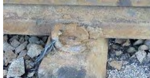
締結装置の老朽化状況 (プラブムリー駅構内 323+)
