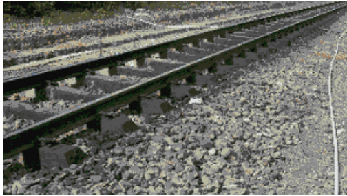
道床 (バラスト) の不足状況 (カラングェンダー駅起点方踏切付近 350+)
