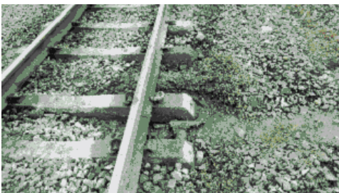
雨水による道床流失と締結装置の脱落 (グヌンメガン駅付近 368+)
