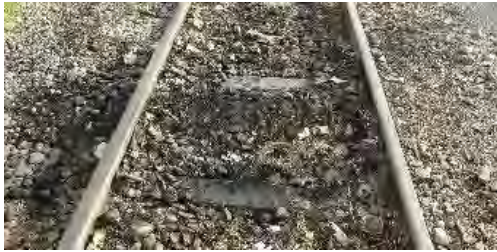
道床内への土砂混入状況 (プラブムリー駅構内 323+)
