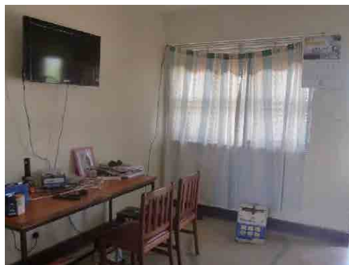
図 2.1.6 宿舎の電気設備
