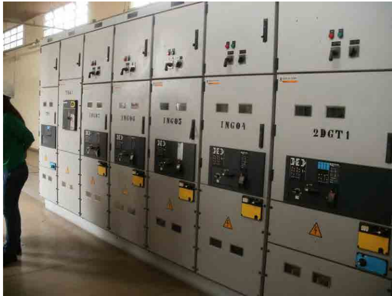
図 4.3.3 配電変電所の中圧開閉器 (AMPLA)
