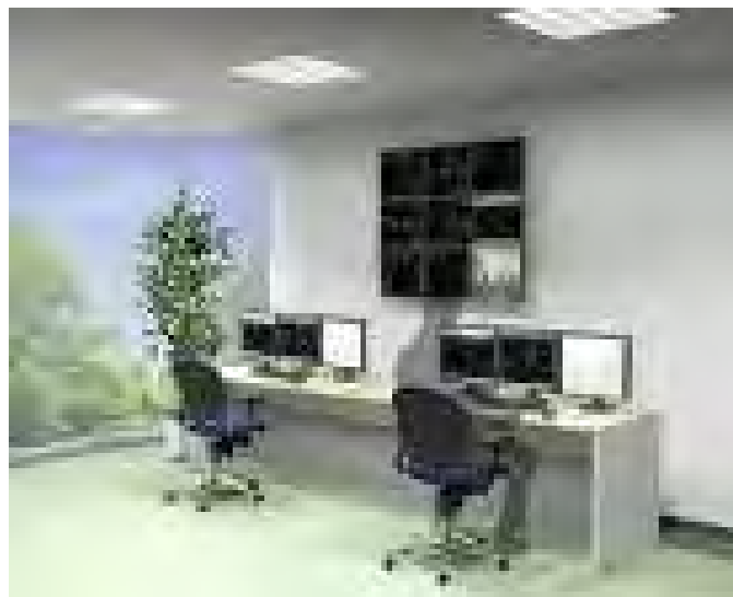
図 5.2.2 コントロールセンターのオペレータールーム
