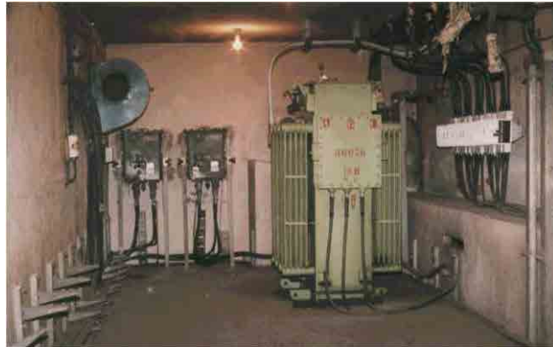
図 4.2.3 地中配電設備の例
