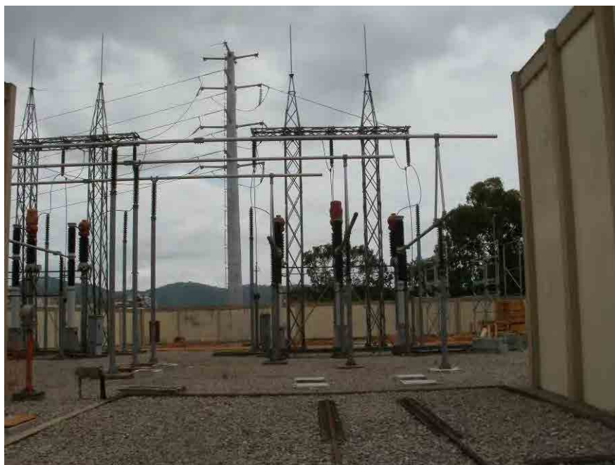
図 4.3.2 代表的な配電変電所 (AMPLA)
