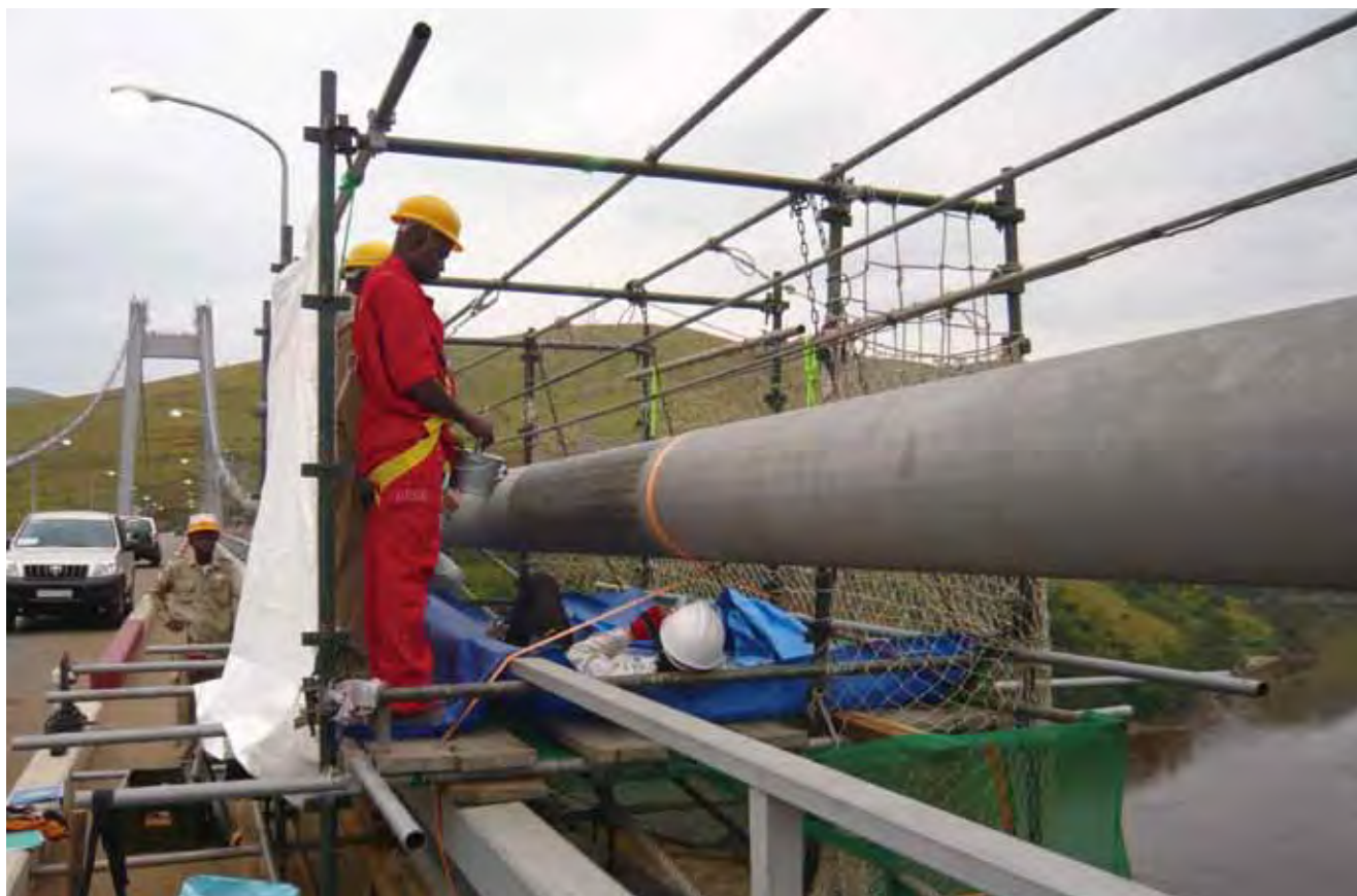
約30年前に円借款で建設されたコンゴ民主共和国のマタディ橋のケーブル開放調査の様子。現在も適切に維持管理されている
