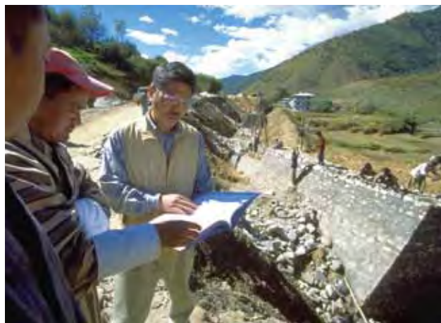
ブータンに派遣されている道路管理のシニア海外ボランティア。基礎インフラの整備は国家としての最大の課題。首都ティンプーへの輸送路確保のため、ハイウェイ突貫工事が行われている
