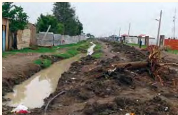
市内で舗装されている道路はほとんどないうえにブラックコットンソイルと呼ばれる土質によって、雨季には四駆、ロバすら通行できず陸の孤島になってしまう
