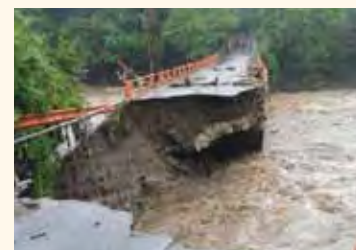
大雨によって橋脚と取り付け道路の下流側が大きく破損しており、コミュニティの手によって封鎖されている
