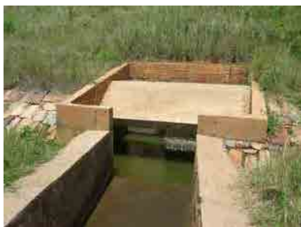
Prise d'eau (portion de sortie)
