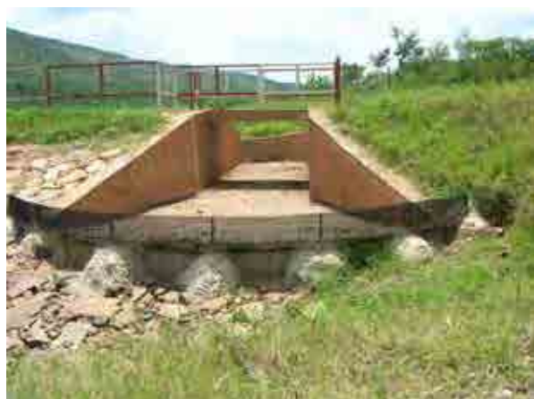
Bouche du déversoir
