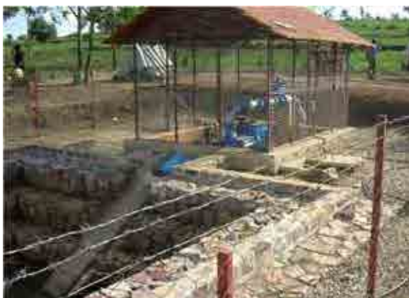
Installations de pompage
