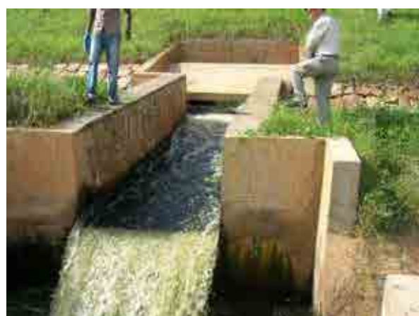
Prise d'eau (portion de sortie)
