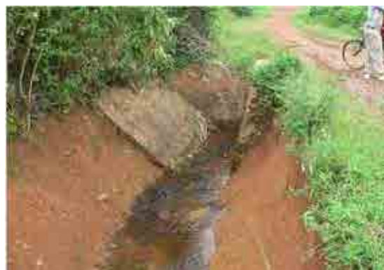
用水路は下流約50mで終点、道路下の暗渠を経て河床部へと下る。
