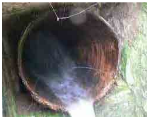
導水管はφ600mm、鋼管で腐食が進行中
