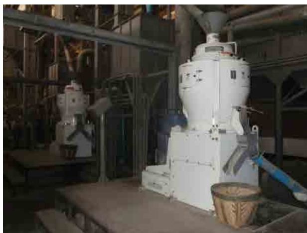
大型精米工場（MAPT No.612 精米工場が民営化されたもの） 円借款で日本の精米プラントが設置されたが、老朽化のため 主要構成機器は中国製やタイ製に置き換えられている。
