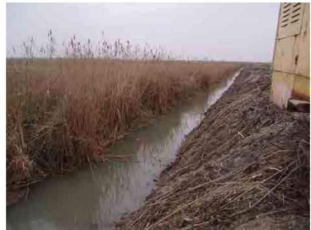
Azizbayov排水路。片側メンテナンス中2006年 にメンテナンスが行われた。〔イミシュリ地区〕
