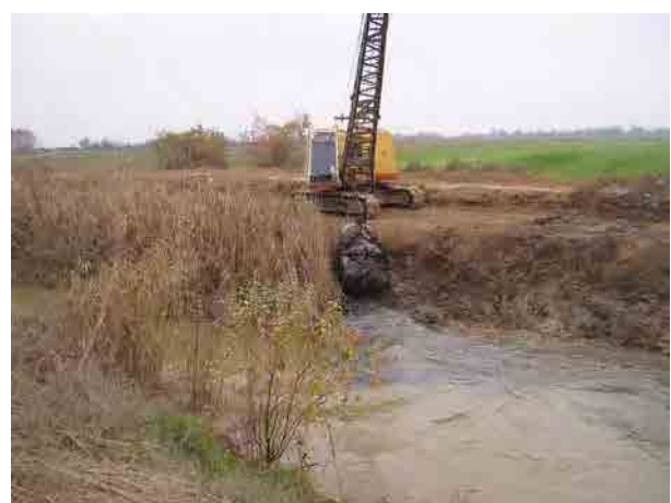
Khangizi用水路メンテナンス状況 〔ベイラガン地区〕
