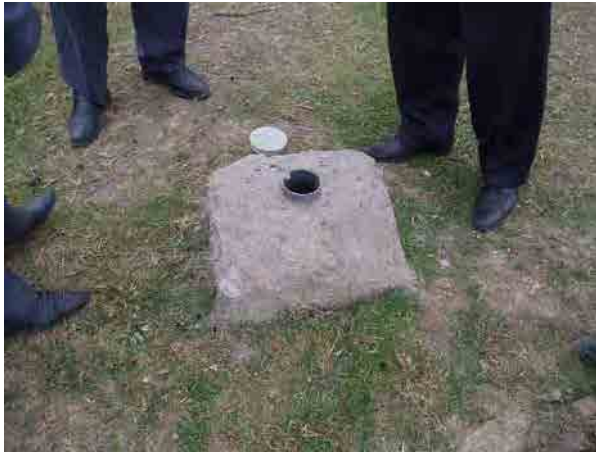
地下水位観測孔。ペイラガン地区に260カ所、 全国に8,600カ所ある。〔ペイラガン地区〕
