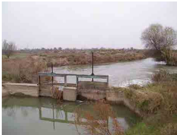
Boztapa用水路。ゲートは老朽化し、下流部 は広く洗掘されている。〔イミシュリ地区〕
