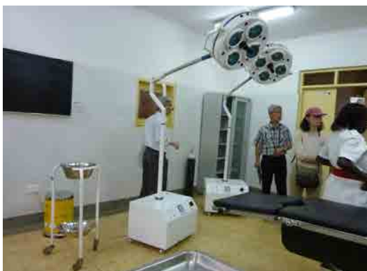
既存手術室：天井取付けの無影灯が故障中のため、モバイルタイプで対応している。
