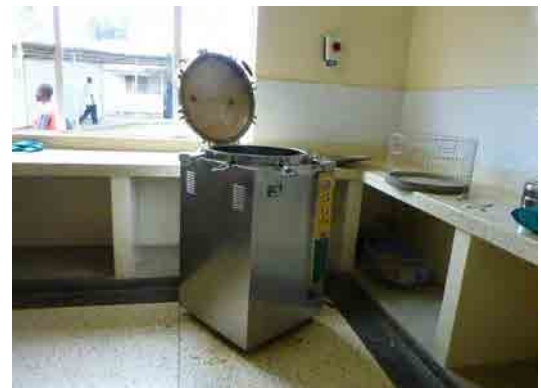
手術棟の材料滅菌室に設置された高圧蒸気滅菌器
