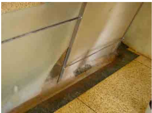
既存手術棟内部：老朽化や破損が著しく、衛生環境の面でも良いとは言い難い。
