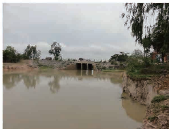
ボックスカルバートの排水断面が小さくボトルネックとなっている。(Clv-2)
