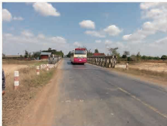
ペーリー橋は耐荷力が小さく、床版が鋼板パネルであるため通行時に振動があり、車両は徐行通行せざるをえない。(BR-7)
