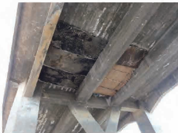
PC 桁橋は老朽化しており、構造的には落橋寸前の危険な状況と判断される。(BR-8)
