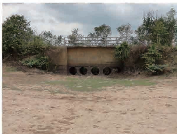
パイプカルバートの排水容量は小さい。(Clv-1)
