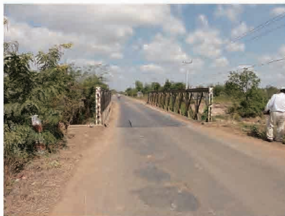
1車線ペーリー橋位置では対向車がある時は待機し交互通行する。(BR-11)
