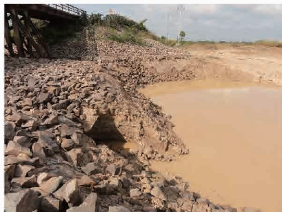
洪水時には橋梁下での流速が早いいため橋梁周辺は激しく浸食され、安定が損なわれている。(ほとんどの橋梁が同様の状況である。)
