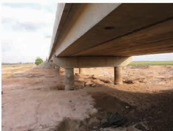
国道8号線の橋梁。すべての橋梁がPCホロー桁形式である。
