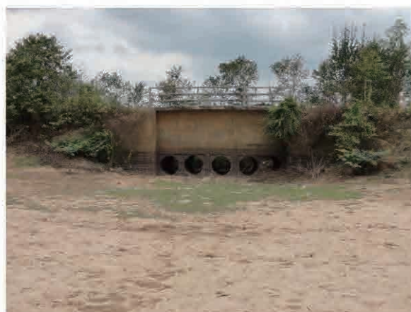
パイプカルバートの排水容量は小さい。(C1v-1)
