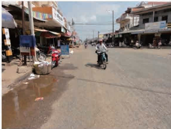
街路の状況 側溝がないため路肩に水が溜まっている。
