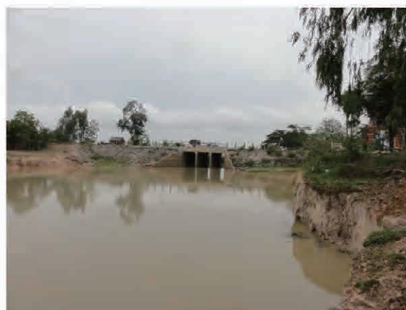
ボックスカルバートの排水断面が小さくボトルネックとなっている。(C1v-2)
