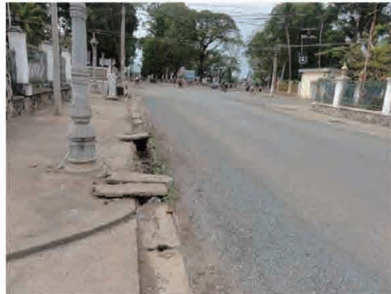
国道5号線市内区間の状況 側溝はサイズが小さく損傷し流れていない。 側溝の蓋がない箇所もある。
