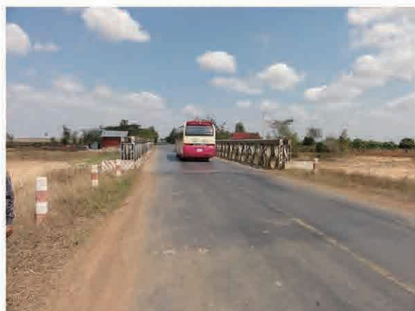
ペーリー橋は耐荷力が小さく、床版が銅板パネルであるため通行時に振動があり、車両は徐行通行せざるをえない。(BR-7)
