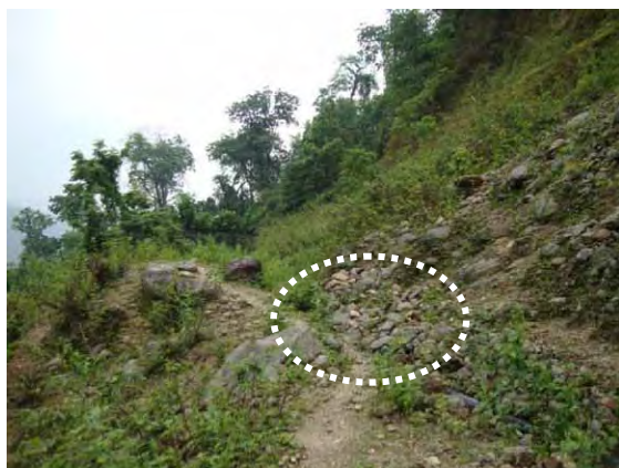
山崩れで壊された管路（…線で囲んだ部分）
