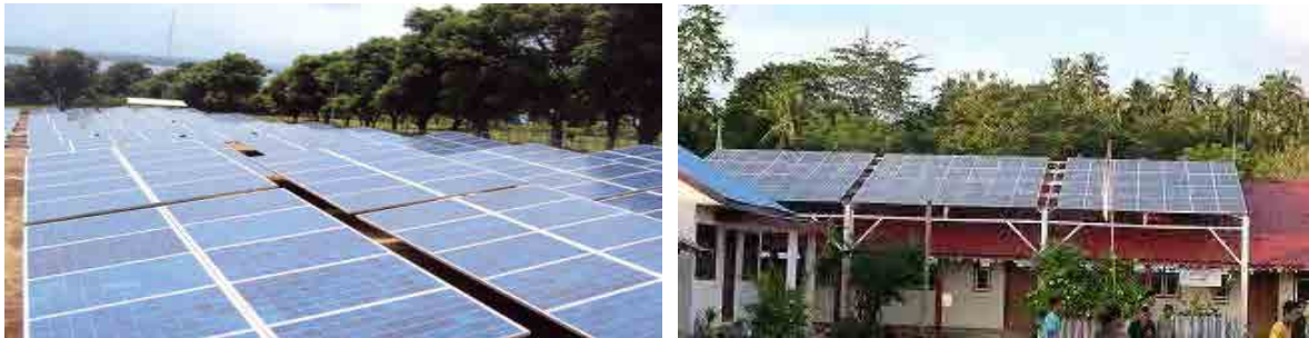
Gili Trawangan PV+ディーゼル発電機
