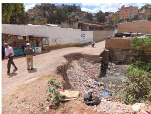
Simón Bolívar School : 避難所になっているが、洪水で壁が破壊された。
