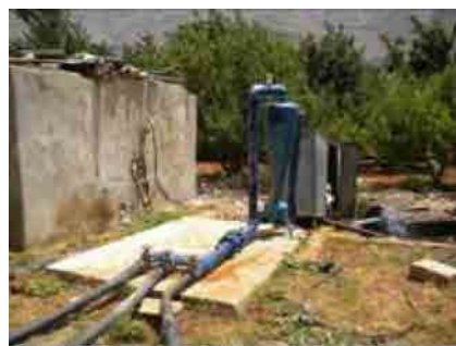
Surghaya（ダマスカス郊外県） サイクロン・フィルター
