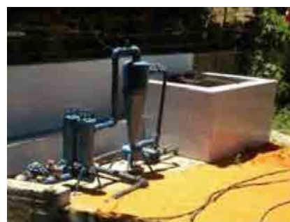
Arne（ダマスカス郊外県） コントロールユニット サイクロン・フィルター付き
