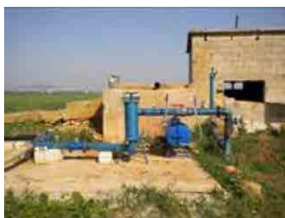
Halfaya（ハマ県） コントロールユニット
