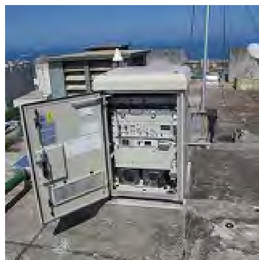
ボックスに収納された10W GF送信システム
