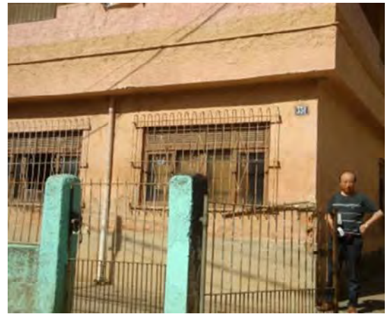
河川の氾濫で浸水位が 3m に達した。
