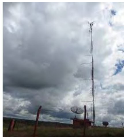
ロマリア市営局 既設アンテナ鉄塔 (アナログ)
