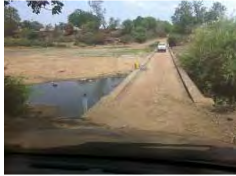
17号線沿いのカラ橋（改修の要請済）
