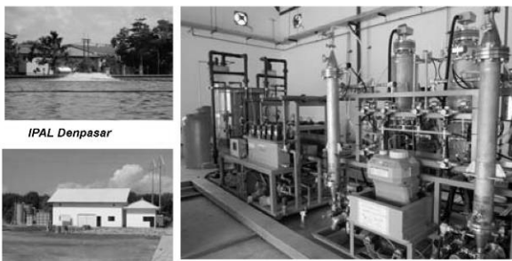
Unit Test Instalasi Air Reklamasi
