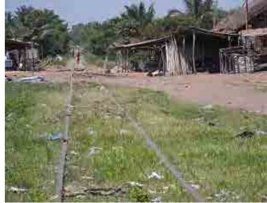
【Notse駅】噴泥化している。本線のみ運行可能（副本線の名残はあるが使用不可能な状態）
