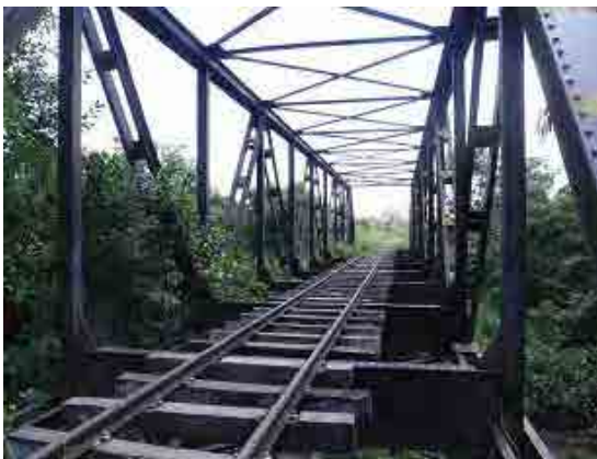
【Walaha駅付近】枕木が傾いて設置されている。（線路直角方向ではない）
