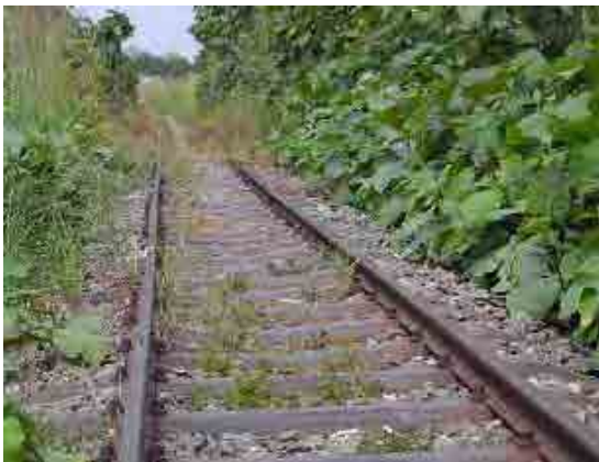
【Anie駅付近】この付近はかろうじてバラストが敷設されている。
