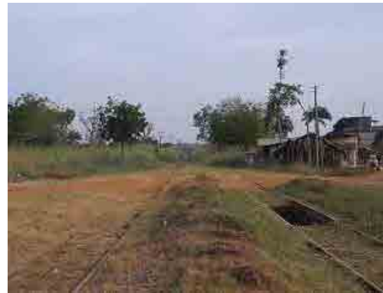
【Blitta駅】噴泥化している。
