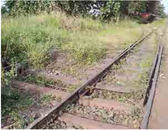
【Palaga駅】分岐器は機能していないため、副本線は使用できない。
