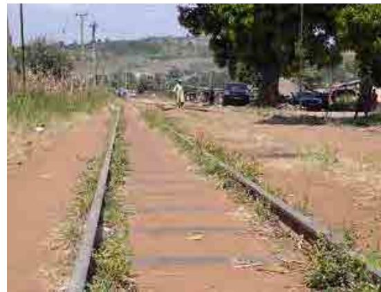
【Atakpame駅】噴泥化している。本線のみ運行可能（副本線の名残はあるが使用不可能な状態）
