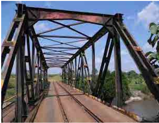
【Haho River付近】並行する国道が水害で流出した際に、道路併用のために敷鉄板が設置された。
