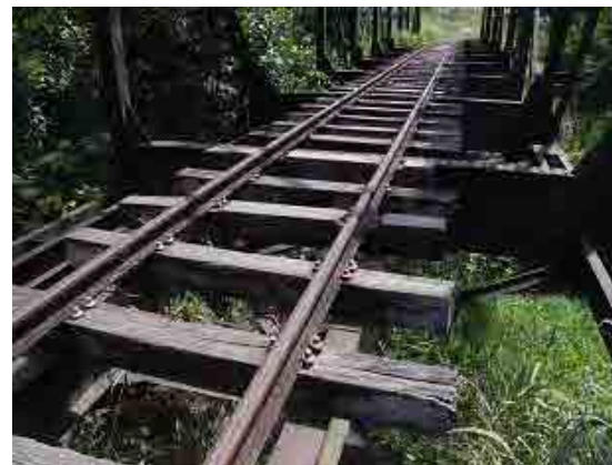
【Walaha駅付近】左と同じ橋梁であるが、枕木の一部に割れが見られた。
