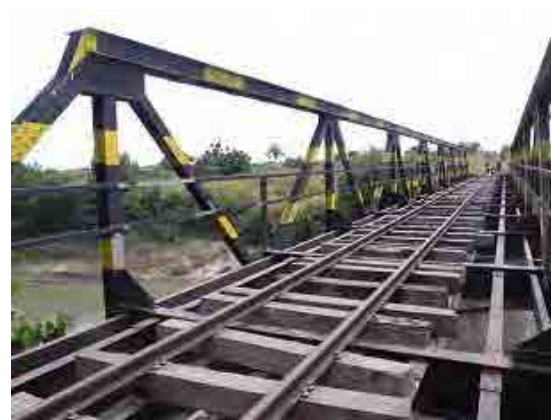
【Anie駅付近】左と同じ橋梁であるが、この橋梁の枕木も傾いて設置されている（線路直角方向ではない）。
