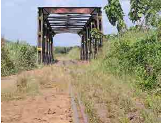
【Haho River付近】噴泥化している。
