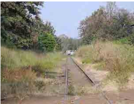
【Pagala駅】噴泥化している。レールの通りが不適切
