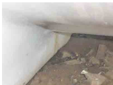
水タンク底部の亀裂
