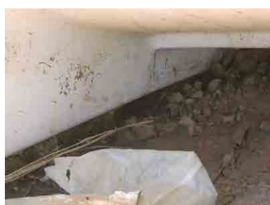
水タンク底部の亀裂
