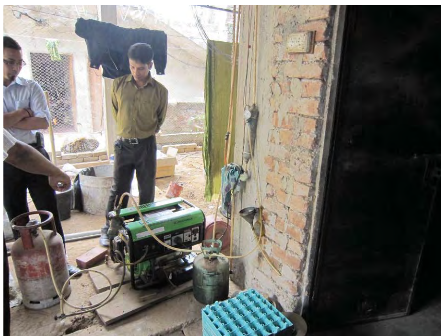
図 30: 小型の非常用ガスエンジンの利用事例
