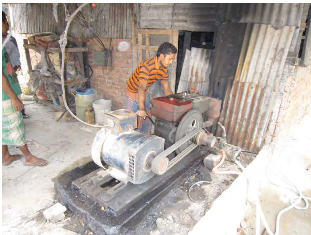
図 28: ディーゼル発電機におけるバイオガス混焼事例
