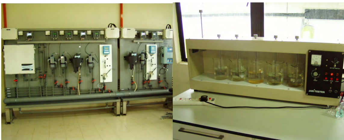
図 II -2.16 セベラッグ・タメロー浄水場内の水質分析室 （2011年8月から試験運転中）
