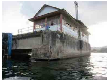
(43) Damaged Abutting Beam (MP/offshore), Rebars exposed & concrete deteriorated រៀបចំដោយក្រុមសិក្សាគម្រោង
