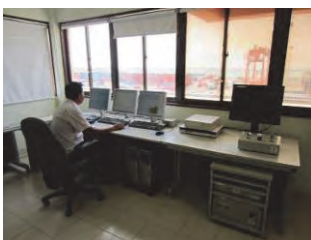
(16) VTMS (Control room)
