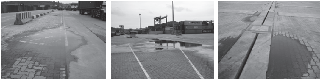
図 5.13-7 コンテナバースの劣化状況
