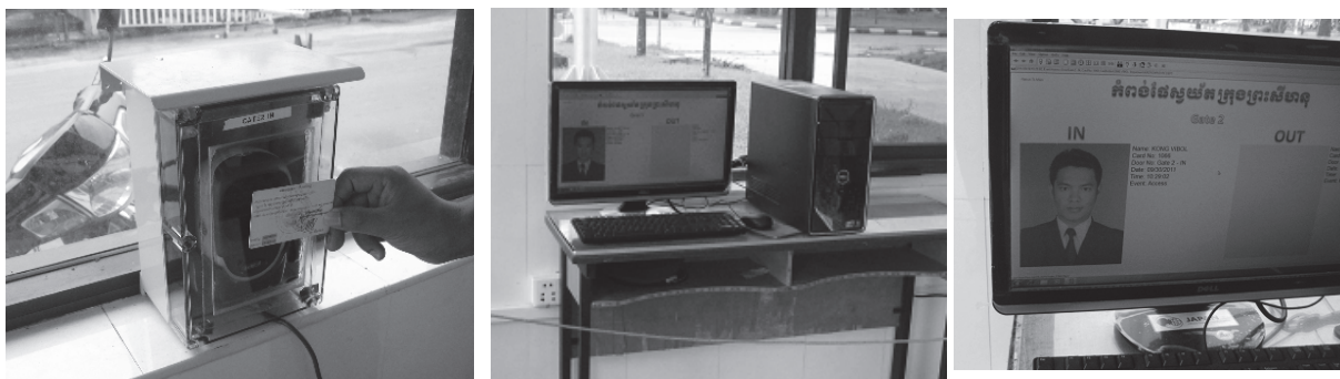
図 5.12-4 ゲート 2 で使用されていたリーダーとモニター設備
