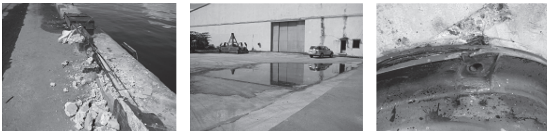
図 5.13-6 ニュー・ジェティの劣化状況
