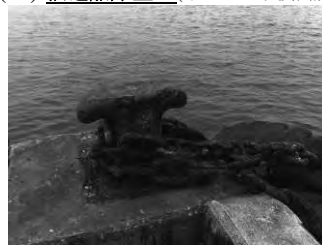
(18) 油送船岸壁-7 (係船柱：腐食)
