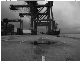
(7) コンテナ岸壁-3 (エプロン沈下箇所)
