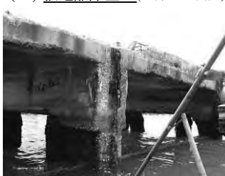
(17) 油送船岸壁-6 (防衝工：欠損)
