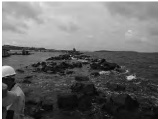
(4) 北防波堤 (北) -4 (天端が欠損している断面)
