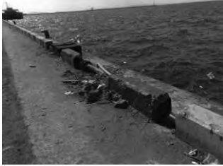
(4) 新港岸壁-4 (車止め：破損)
