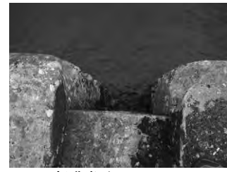
(3) 新港岸壁-3 (ラダー：欠損)
