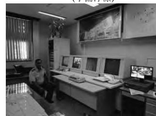
(15) CCTV システム-2 (CCTV 操作/監視室)
