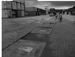
(9) CT 場内道路-2(ILB 舗装部：部分沈下)
