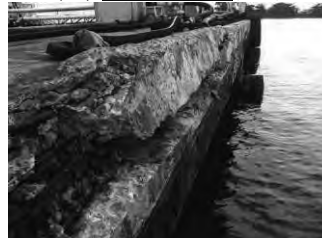
(15) 油送船岸壁-4 (車止め：破損箇所)
