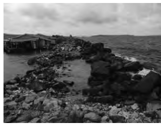
(2) 北防波堤 (北) -2 (石及び盛土材が不足する断面)
