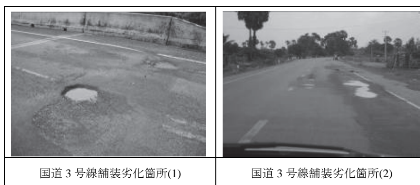
図 2.4-5 国道 3 号線の劣化状況
