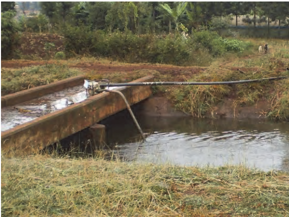
リンク水路 1 沿いのポンプ取水。許可を得ていない場合は、MIS が直接か、WUA に連絡してポンプを撤去する。無許可ポンプはほとんどみられなかった。
