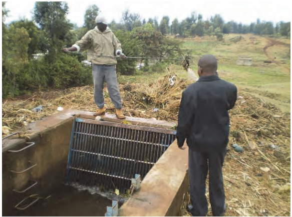
リンク水路 1 のサイフォン導入口のスクリーン。専任の掃除人が終日塵芥を除去している。
