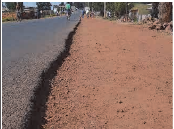
舗装と路肩の境界部に大きな(10cm程度)段差がある。車道上を走行する自転車が見える。
