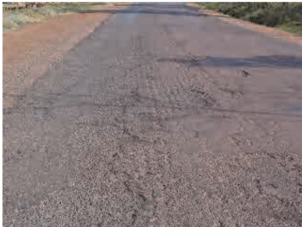
舗装のひび割れや剥離が車道全面に拡大している。
