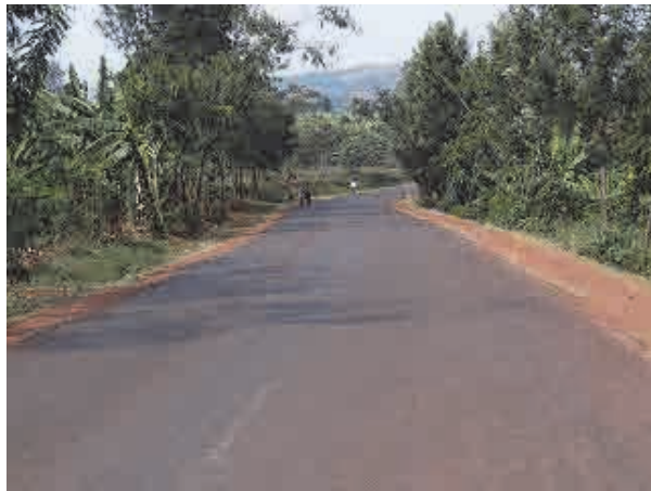
道路劣化のため、道路表面にクラックが見られる。
