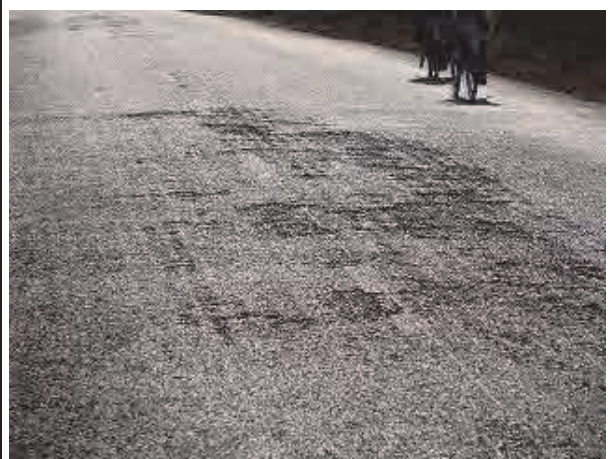
アスファルト舗装道路のひび割れ及び剥離状況
