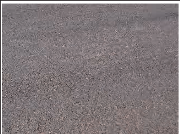
ひび割れ、剥離が進行しつつある。
