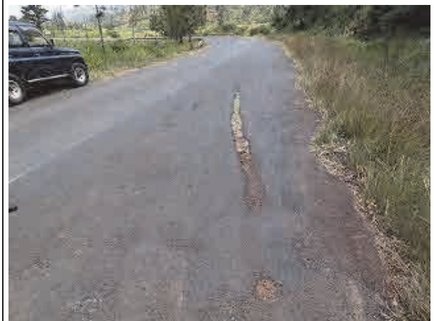
下り坂の急カーブ地点での急ブレーキ等による舗装の損傷状況。
