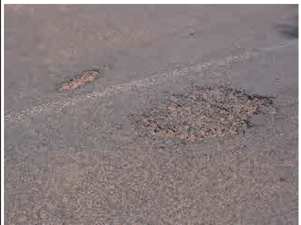
ポットホールを生じる可能性のあるひび割れ及び剥離状況。
