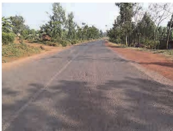
舗装表面にひび割れや剥離が多く点在する。
