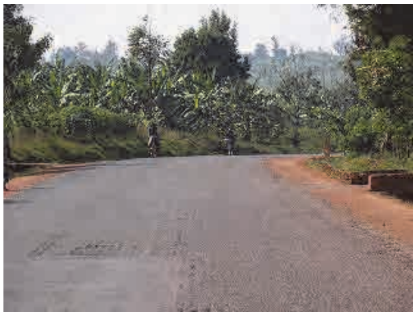
カーブを安全に曲がるための交通標識・交通安全施設を必要とする。舗装表面のひび割れや剥離。
