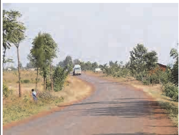
道路の見通しが良く、自動車が安全に走行可能な区間。道路表面は、ひび割れや小規模のわだちが見られる。
