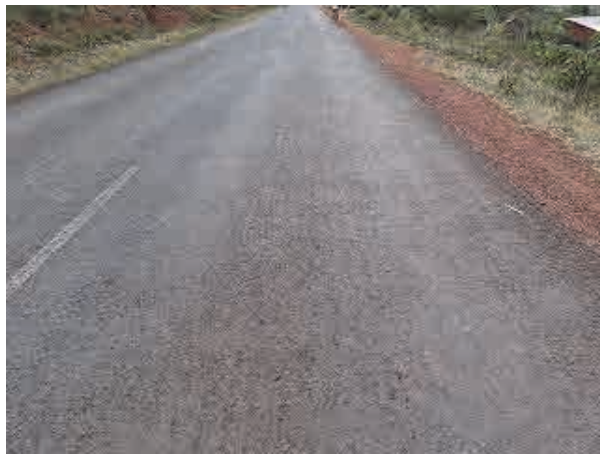
ひび割れ・剥離が道路全面に拡大
