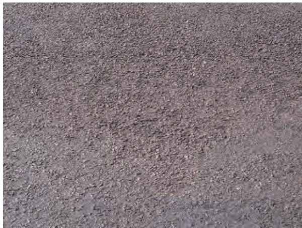
ひび割れ・剥離を生じた路面
