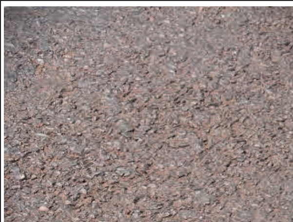
老朽化のため道路全面に広がるラベリング
