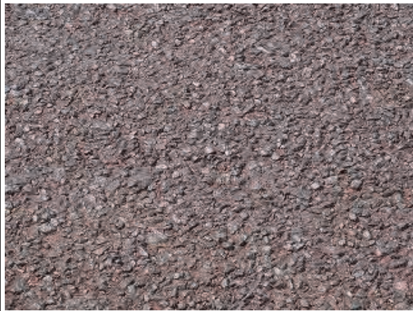
舗装が老朽化し、ラベリングが見られる。
