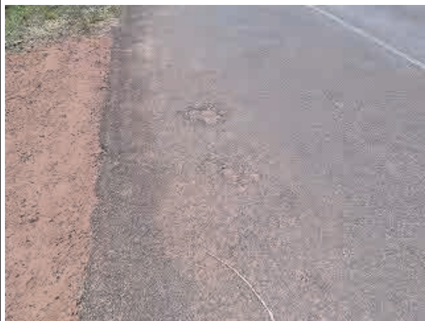
ひび割れからポットホールへと進行しつつある舗装表面。
