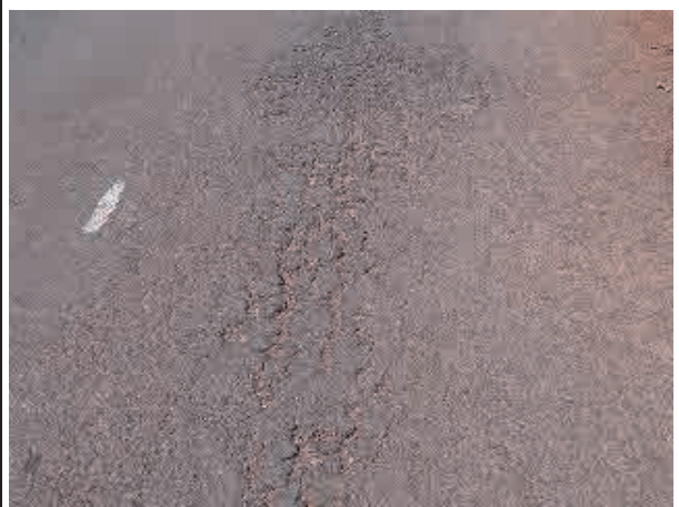
ひび割れが進行しているため、マーキングが行われ、補修予定。
