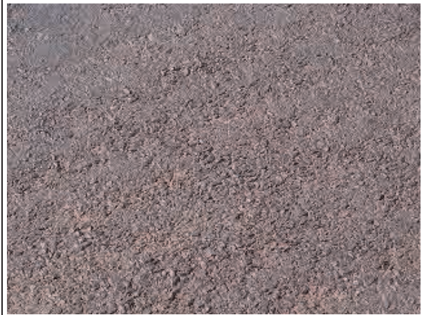
ひび割れや剥離を生じている舗装面
