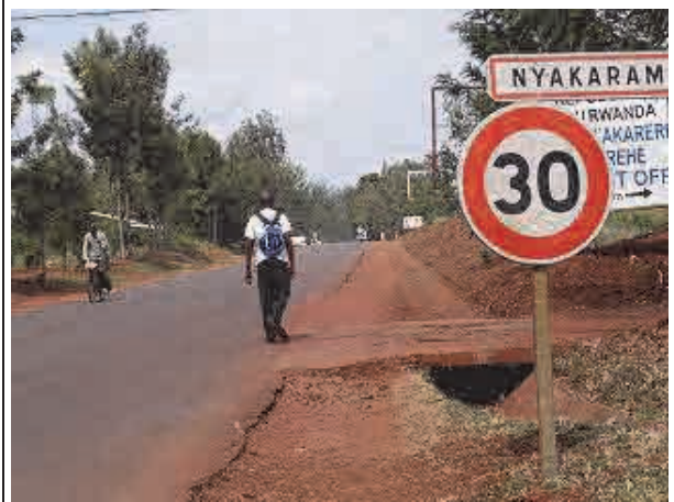
路肩が舗装されていないため、車道を利用する自転車や住民。町・村区間の端部で、30 km/hr の制限速度が開始されている。
