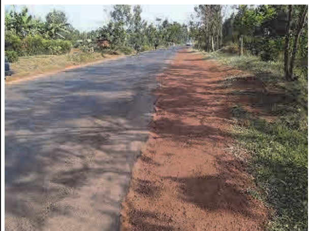
舗装と路肩の境界部に段差がある。
