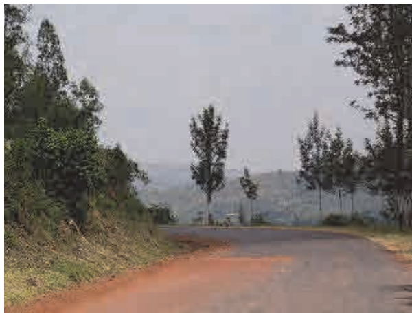
急カーブ前の舗装修復箇所。交通安全標識・交通安全施設を必要とする。
