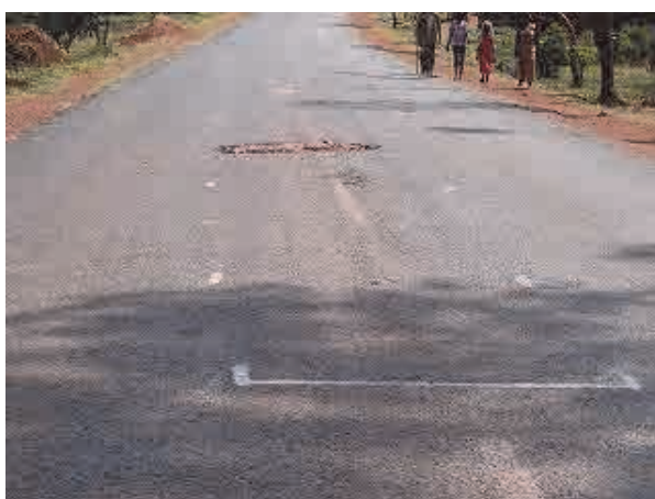
ポットホールやひび割れが見つけれられた後、マーキングが行われ、修復が行われる予定。
