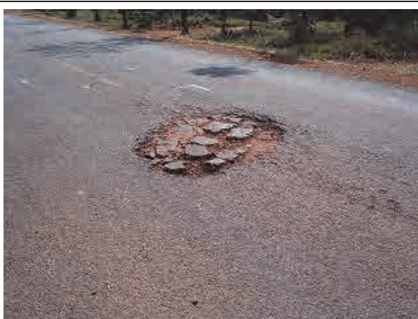
ポットホールが見つけれられた後、マーキング及び石詰が行われ、修復が行われる予定。
