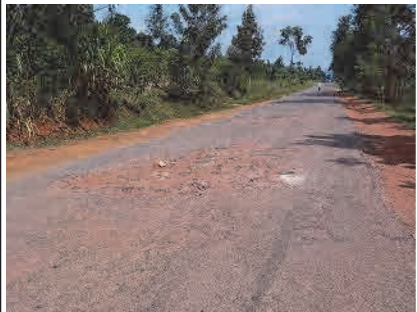
排水不良が原因で舗装面が劣化し、ポットホールを生じている。
