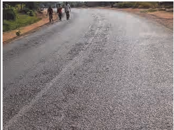
舗装表面に、ひび割れ及び剥離が多く点在する。ポットホールを生じる可能性が高い。
