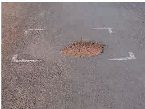
ポットホールが見つけた後、マーキングが行われ、修復が行われる予定。
