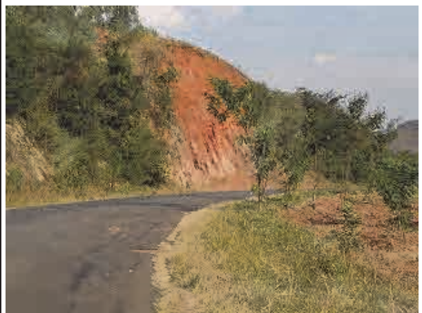
法面防護が必要となる可能性のある箇所。路面のひび割れや小さなポットホールが見られる。
