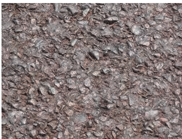
道路全面に拡大しているラベリング状況
