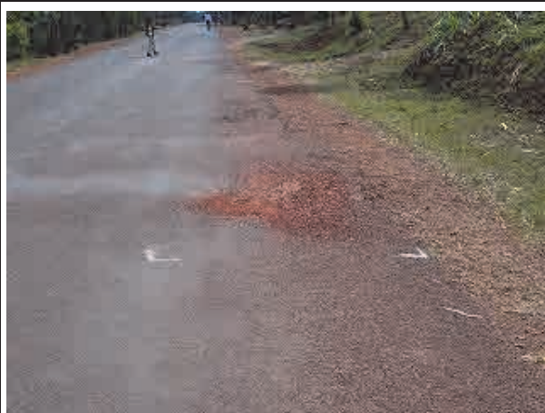
ポットホールをマーキングし、補修を予定している。
