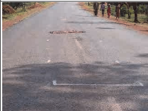
ポットホールやひび割れ箇所へマーキングを行い、修復予定。
