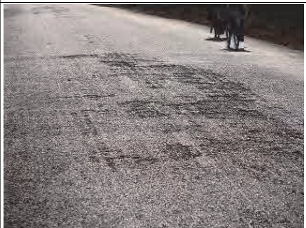
舗装道路のひび割れ及び剥離状況
