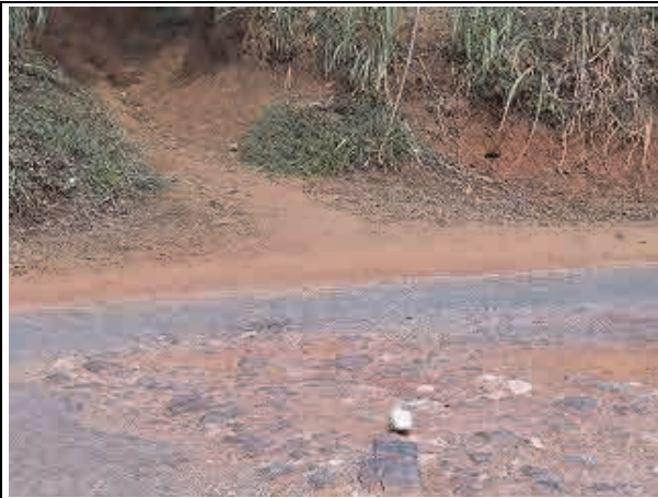
排水不良によるポットホール
