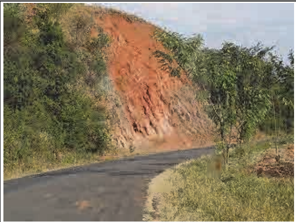
法面の崩落状況
