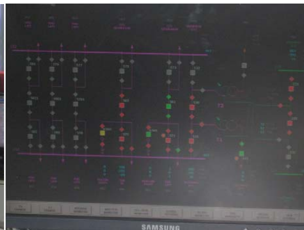
写真 4.4-2 500 kV スイッチヤード制御盤ディスプレイ
