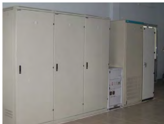
写真 4.4-3 SCADA システム
