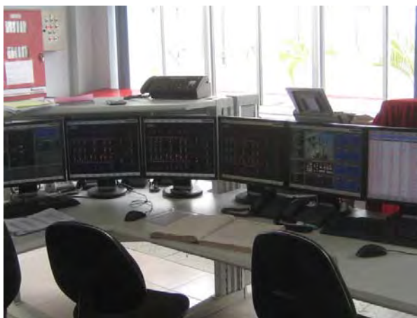
写真 4.4-1 500 kV スイッチヤード制御盤
