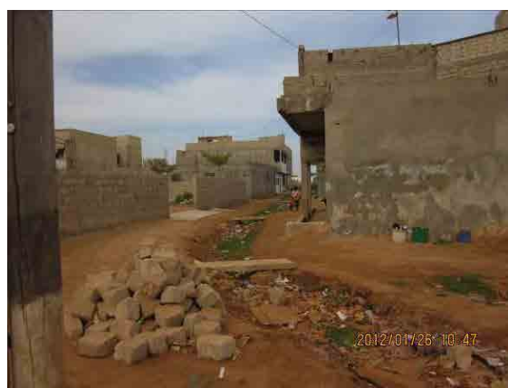
(17)エンバオ川流域の排水路の状況（砂やゴミにより閉塞されている）
