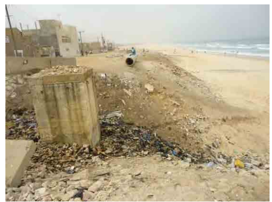
(12) 下水道の沖合放水パイプ（カンパレン海岸）
