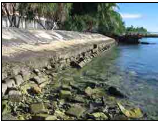
写真 - 1.4.2-19 ホテル裏の堤防の状況
