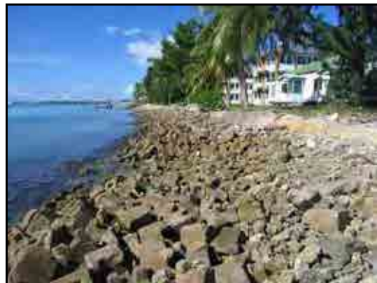
写真 - 1.4.2-16 政府庁舎裏の海岸の状況
