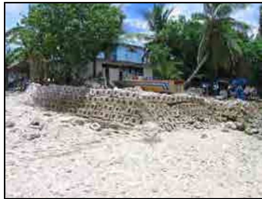
写真 - 1.4.2-20 初等学校裏の護岸の状況
