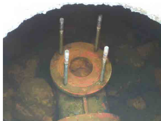
図 9.5-2 破損した空気弁
