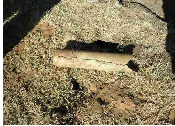
図 9.4-2 漏水の原因となった損傷した既存アスベスト管
