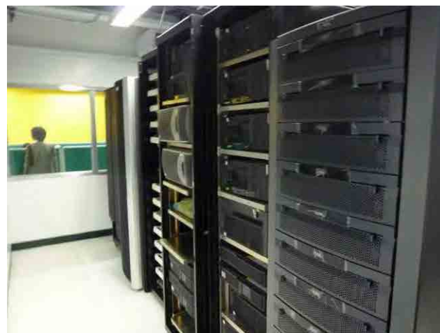
DA-ITCAF のデータセンター内の様子。このサーバーには、AFMIS やデータウェアハウス、各リージョンオフィスのホームページが稼働している。
