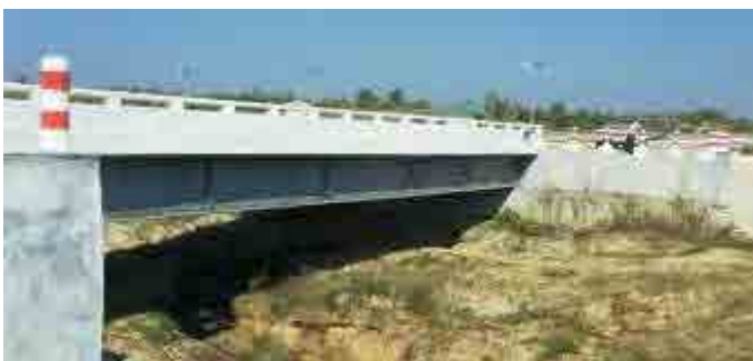
NayPyiTaw 北部橋梁下は工事中のまま
