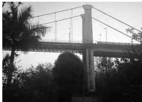
パイロンが傾き中央部が 60cm 下がった Myaungmya 橋 以上
