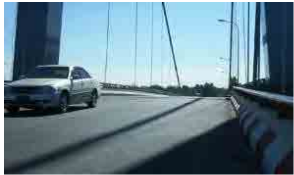
伸縮継ぎ手部が大きくせりあがっている
