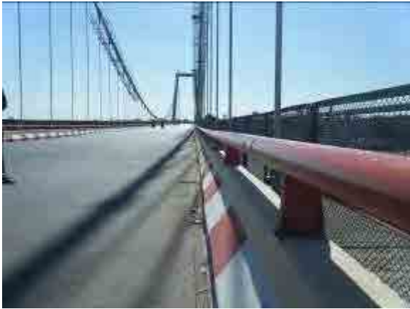
開通当初から大きく撓んでいたという橋面
