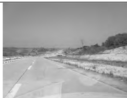
路肩部外側は整備されていない
