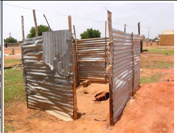
仮設トイレ 間借りの敷地内に設置された仮設トイレ。屋根がなく、ドアも壊れている。(KA-18M カオラック州 ケールアイブポスト中学校)
