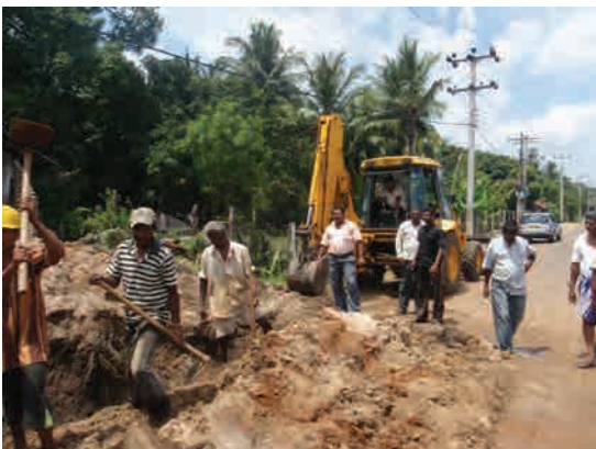
国道 4 号線の工事現場。コントラクター及び重機作業員は南部から来ているシンハラ人であった
