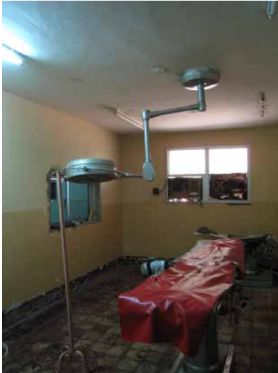
シンジャ教育病院手術室： 无影灯は故障していて使えない
