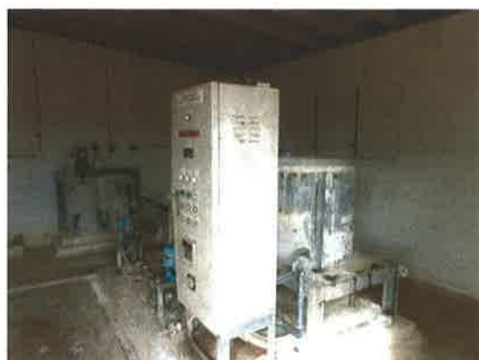
故障中の塩素注入機
