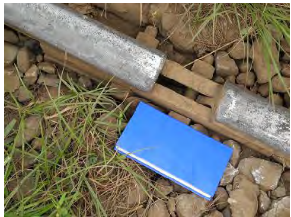
継ぎ目板にレールが固定されておらず、10 cm程度の間隔が空いている（青色の手帳の長辺は16.5cm）。
