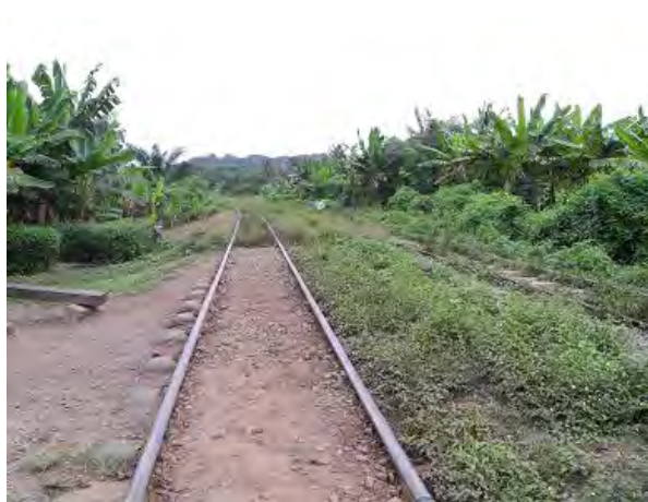
噴泥化した路盤
