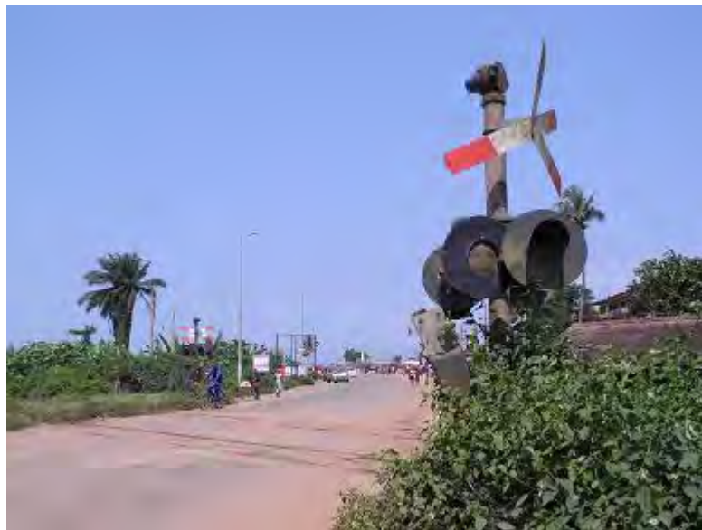
使用されていない警報機
